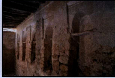
شكل (١٧): يوضح تآكل السطح الخارجي للجدران وسقوط طبقات الملاط.
