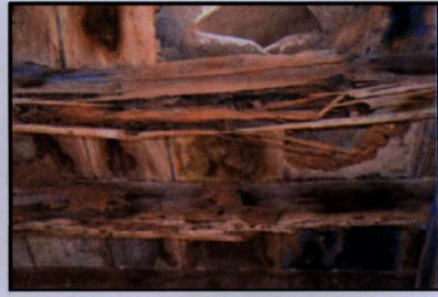
شكل (٢٥): يوضح مظاهر تلف السقف الخشبي.
