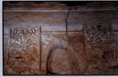
شكل (١٧): يوضح شروخ في الجدران الحاملة للزخارف الجصية وتآكل السطح للزخارف الجصية.
